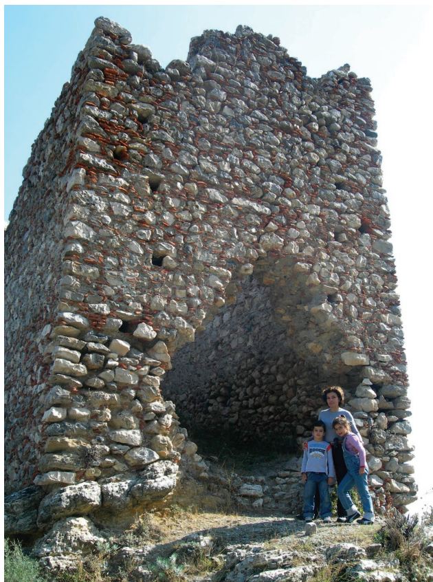
Εικ. 19. Βυζαντινός πύργος στα Καλύβια Σοχάς, Λακωνία, όπου πάνω από την οπή παρατηρείται εκτροπή κάθετου φορτίου περίπου 26 τόνων. Εντύπωση προκαλεί η δυσμενής γωνία θεμελίωσης της λιθοδομής πάνω σε βράχο που παρουσιάζει κατωφέρεια (~20°) προς την εξωτερική γωνία του πύργου.
