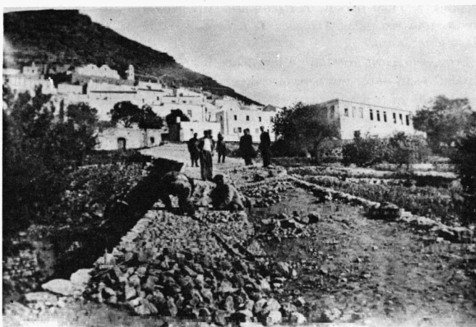
Κατασκευὴ τοῦ Μεγάλου Χογλακαριοῦ ἀπὸ τὸ γραφεῖο «Πρόνοια- Ἔργασια». (Φωτογραφικὸ Ἄρχειο Χ.Μ. Κουτελάκη).
