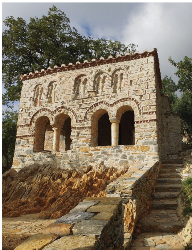
Εικ. 2. Μεσσηνιακή Μάνη, Άι Στράτηγος Καστάνιας. Άποψη της στοάς από τα νοτιοανατολικά, μετά την ολοκλήρωση των εργασιών αποκατάστασης.
