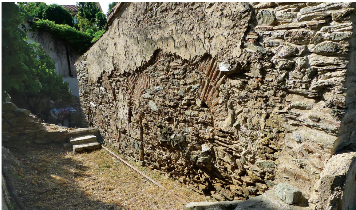
Εικ. 15. Μονή Λατόμου (Όσιος Δαβίδ), καθολικό. Άποψη της βόρειας πλευράς, όπου και τα κατάλοιπα του δίλοβου παραθύρου του πρωτοβυζαντινού ναού.
