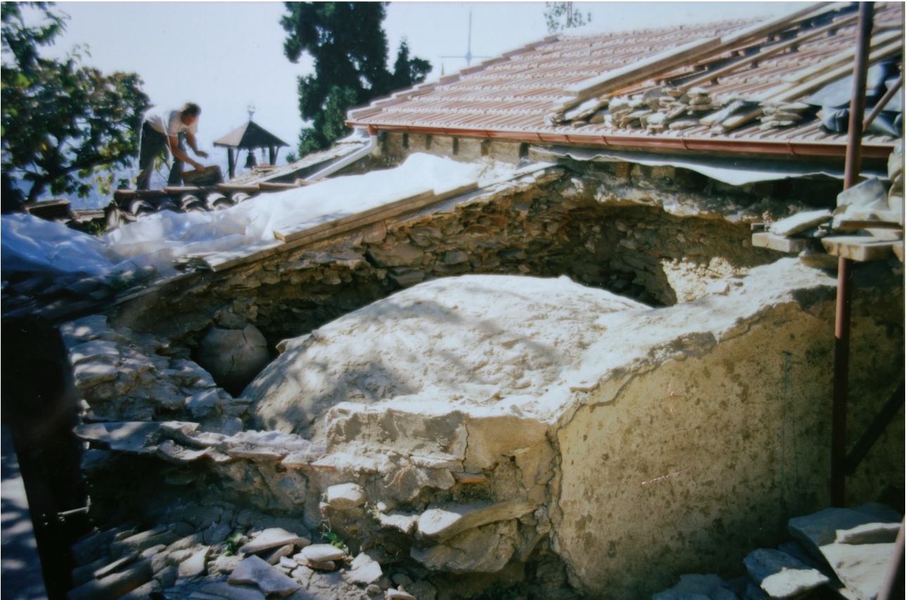
Εικ. 18. Μονή Λατόμου (Όσιος Δαυίδ), καθολικό. Το εξωράχιο της ασπίδας του βορειοανατολικού γωνιακού διαμερίσματος κατά τις εργασίες αποκατάστασης των στεγών του ναού την περίοδο 2000-2001.
