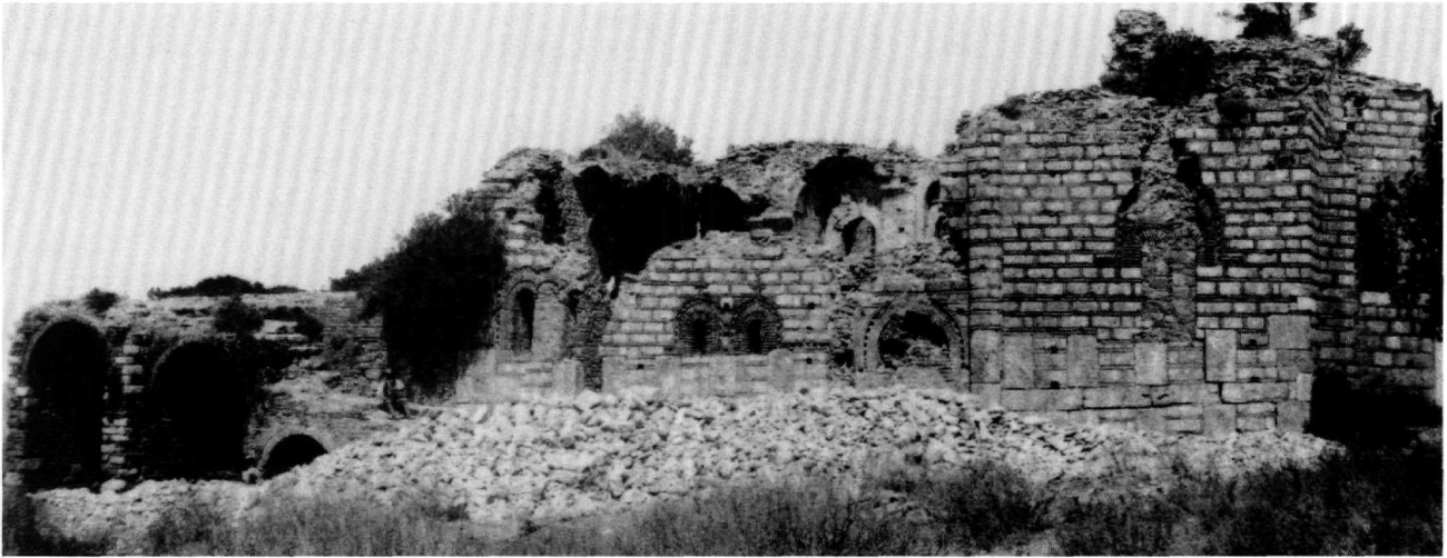
Εικ. 22. Ναός Μεταμορφώσεως του Σωτήρος Χριστιάνων. Η νότια πλευρά πριν από την έναρξη των εργασιών (φωτογραφία Γ. Λαμπάκη).
