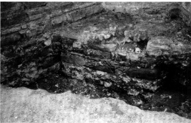
Εικ. 18-19. Ναός Μεταμορφώσεως του Σωτήρος Χριστιάνων. Ερευνητικές εργασίες στην ανατολική πλευρά. Διακρίνεται το αρχικό θεμέλιο της πρόθεσης στη 2η φάση.
