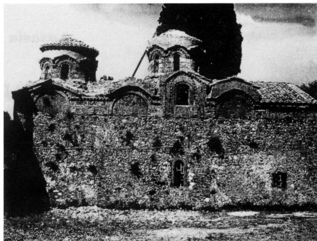
Εικ. 2. Η νότια πλευρά του ναού κατά τη διάρκεια των εργασιών αποκατάστασης (1972).
