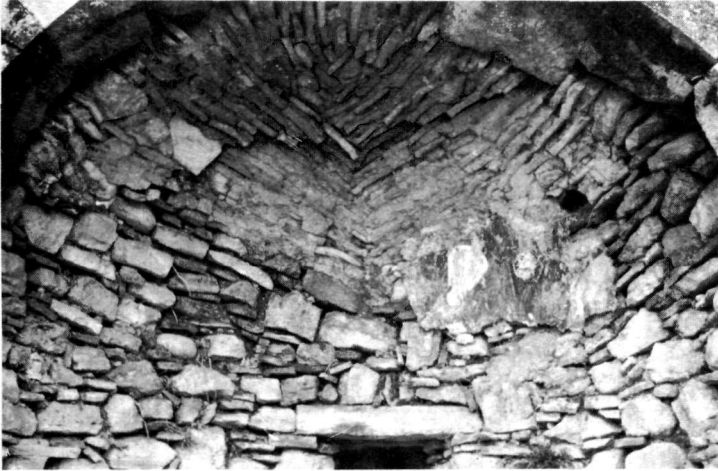
β. Κατασκευή τεταρτοσφαιρίου κόγχης ἱεροῦ. Ἄρχικόν στάδιον λιθοκτιστόν, μεταγενεστέρα κακότεχνος ἀνακατασκευή διά πλίνθων.
