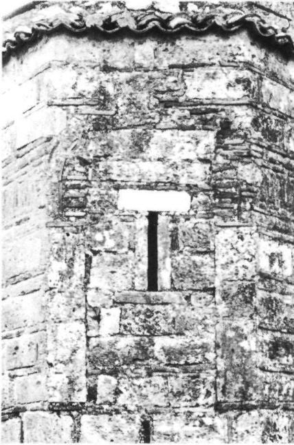
Είκ. 16. "Άγιος Ίωάννης Παλιού Λιγουριού. Άποψη τής ανατολικής πλευράς τής κόγχης τού ιερού. Διακρίνονται τά λείψανα τού δίλοβου παραθύρου.
