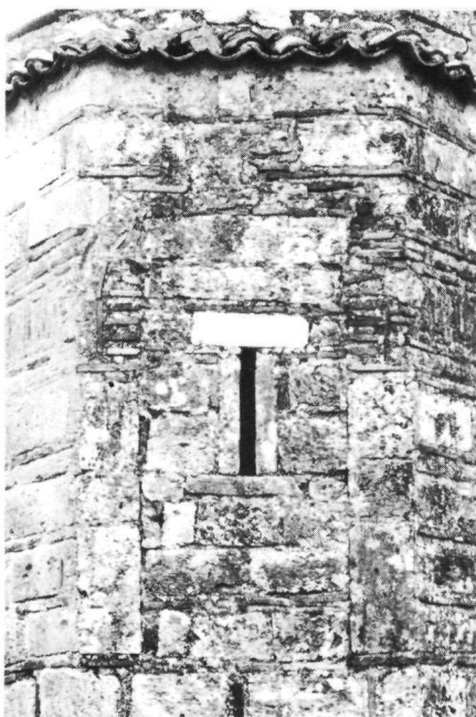
Είκ. 16. "Άγιος Ίωάννης Παλιού Λιγουριού. Άποψη τής ανατολικής πλευράς τής κόγχης τού ιερού. Διακρίνονται τά λείψανα τού δίλοβου παραθύρου.
