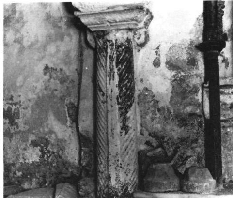
Είκ. 8. Ἐπισκοπή Ἱεράπετρας. Ἅγιος Γεώργιος-Ἅγιος Χαράλαμπος. Ἀνατολικός τοίχος βόρειου διαμερίσματος (δεξαμενῆς). Διακρίνεται, ἀριστερά τοῦ ἀμφικιονίσκου, ἡ νεύρωση πού ἐνίσχυε τή γωνία τῆς δεξαμενῆς ἀπό τή διάβρωση.
