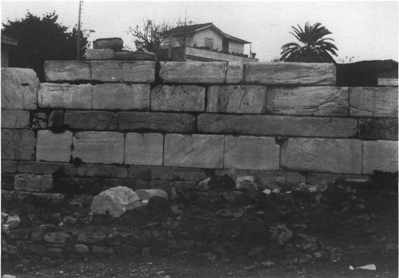
Εικ. 44. Αρχαία Αγορά. Υπολείμματα του υστερορωμαϊκού τείχους στο ανατολικό όριο της οδού Παναθηναίων.
