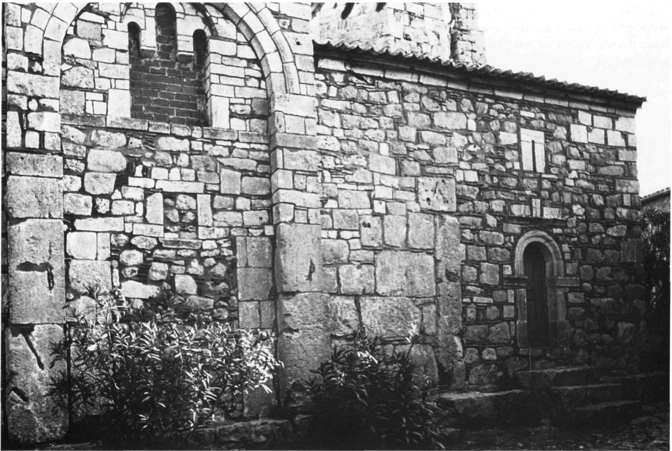
Εικ. 18. Μονή Σαγματά. Καθολικό. Άποψη του δυτικού τμήματος της δόρειας όψης. Διακρίνεται ο κατακόρυφος αρμός και η φραγμένη είσοδος στη λιτή.
