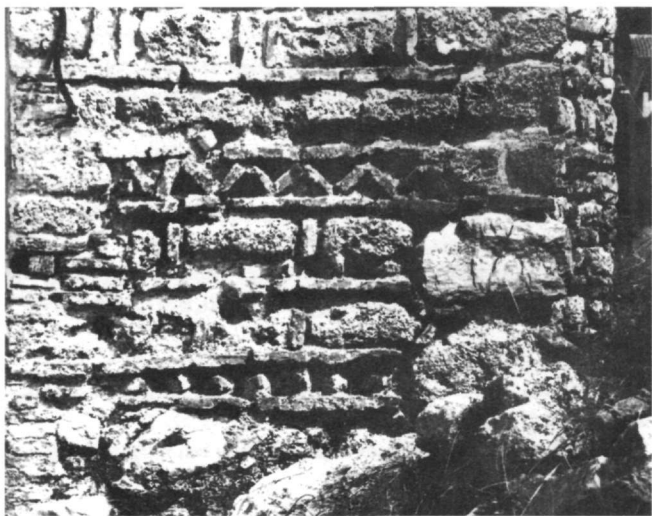
Εἰκ. 20. Μεγάλη Παναγιά. Νότιος τοῖχος ναοῦ. Τὸ τμήμα πρὸς τὴν ἀκμὴ μετὸν ἀνατολικὸ τοῖχο.
