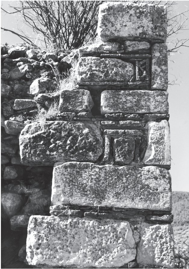
Εικ. 6. Λάτρος, ερειπωμένος ναός στο Kahve Asar Ada. Λεπτομέρεια τοιχοποιίας στη βορειοδυτική γωνία του ναού (2000).
