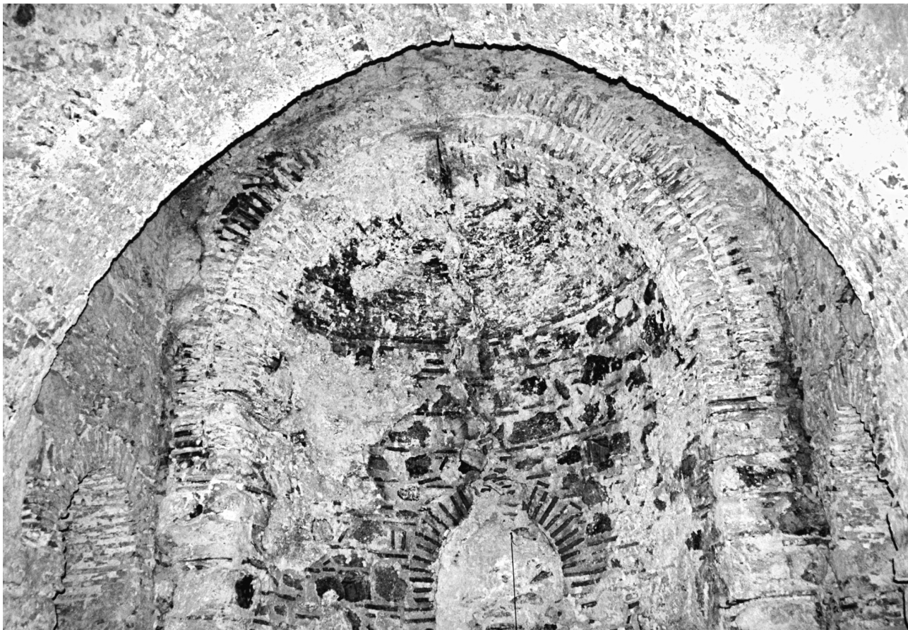
Εικ. 15. Άποψη του εσωτερικού της αψίδας του ιερού. Διακρίνεται η υποχώρηση στο τόξο μετώπου.
