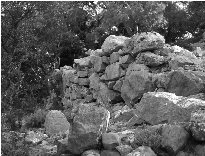
Εικ. 17: Τμήμα αναλημματικού τοίχου στη δυτική κλιτύ του λόφου του Αγίου Φωκά.
