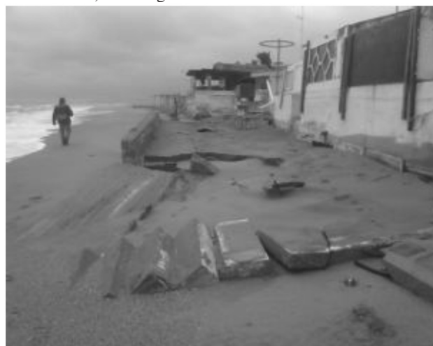
Σχήμα 6: Χαρακτηριστική περίπτωση κατεστραμμένης περιφραξης κατοικίας από το χειμérico κύμα σε περιοχή μεταξύ των τομών 8 και 9.
