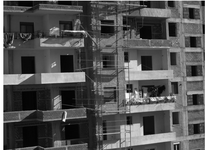
Εικόνα 6: Πολυκατοικία αντιπαροχής στο Αργυρόκαστρο. Οι εργασίες στα διαμερίσματα ολοκληρώνονται από τους αγοραστές σε διαφορετικές φάσεις.
