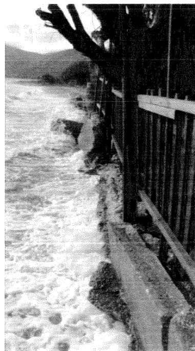
Εικόνα 6. Αυθαίρετες κατασκευές στην παράκτια ζώνη που καταστρέφονται από τις θαλάσσιες διεργασίες Δ της εκβολής του Καινούριου ρέματος
