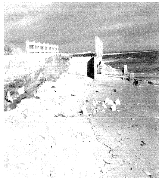
Εικόνα 3. Καταστροφή αναχώματος γέφυρας και παραλιακού δρόμου από την υποχώρηση και διάβρωση της ακτής στην περιοχή Μοναστηράκι Καβάλας (2002)
