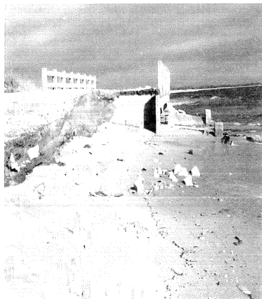
Εικόνα 3. Καταστροφή αναχώματος γέφυρας και παραλιακού δρόμου από την υποχώρηση και διάβρωση της ακτής στην περιοχή Μοναστηράκι Καβάλας (2002)
