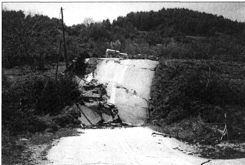
Σχήμα 1. Αναθόλωση των εδαφικών μαζών στη στροφή του αυτοκινητόδρομου με έντονη παραμόρφωση και μεταβολή της μορφολογίας.
