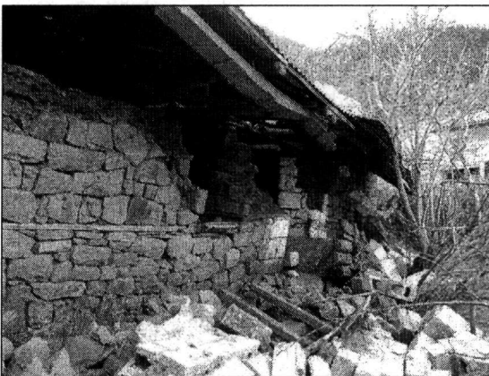
Σχήμα 6. Κατεστραμμένη οικία μέσα στη ζώνη των κύριων αστοχιών του οικισμού.
