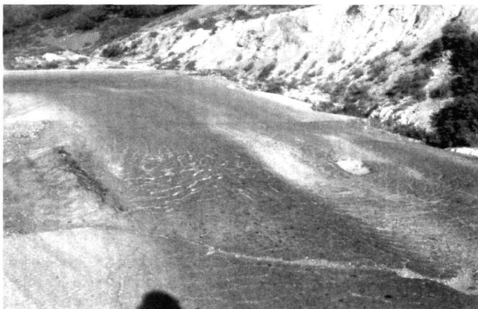
Εικ.6 Καθίζηση οδοστρώματος Fig.6 Subsidence of the road surface
