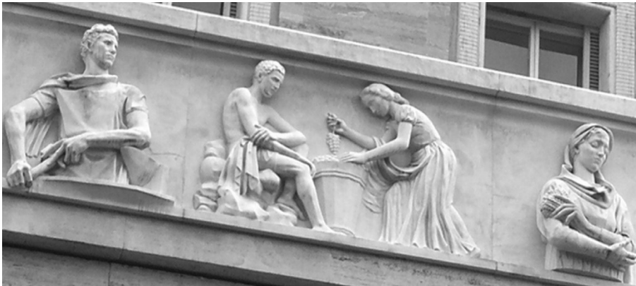
Εικ. 15-17: Λεπτομέρειες από τη ζωφόρο του κτηρίου Α στην Piazzale Augusto Imperatore. Εμφανείς οι ομοιότητες με τα ανάγλυφα της Ara Pacis Augustae.
