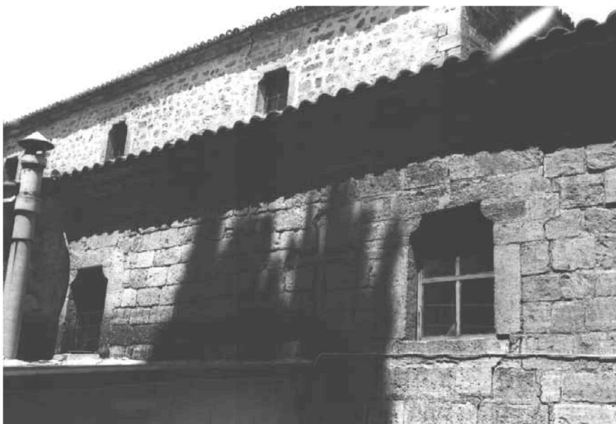
Εικ. 20. Άγιος Γεώργιος Σιτοχωρίου, παράθυρα νότιας πλευράς. The church of St. George of Sitohorion, the windows of the southern side.
