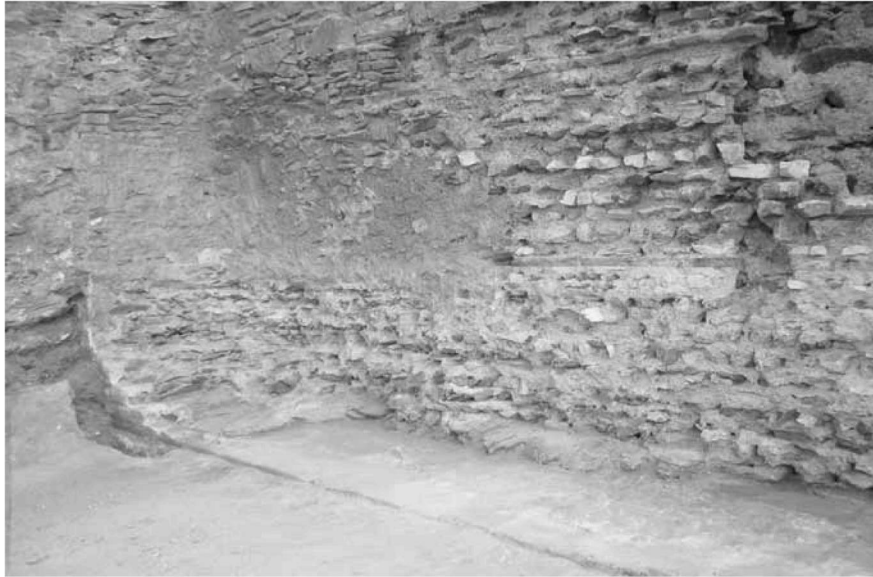
Εικ. 5. Λεπτομέρεια τοιχοδομίας του μεταπυργίου Π12-Π11. Ph. 5. La partie des remparts entre la tour no 12 et la tour no 11. Détail de la construction.
