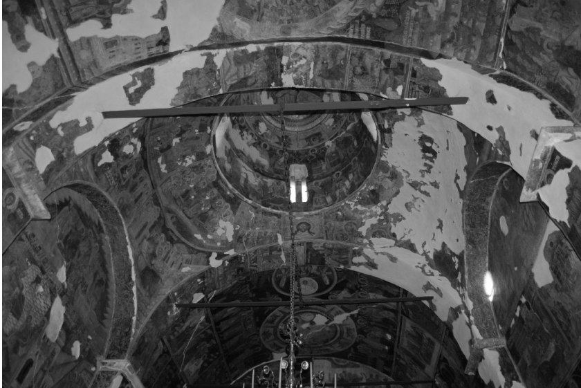
ΕΙΚΟΝΑ 6: Νέα Μονή Ζαλόγγου. Καθολικό. Άποψη του τρόπου στήριξης του τρούλου από τα δυτικά (Φωτογραφία Στ.Β. Μαμαλούκος, 2007)
