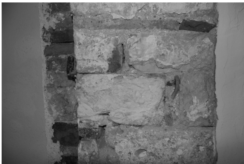
ΕΙΚΟΝΑ 25: Τμήμα τοιχοποιίας του μνημείου όπου διακρίνεται η ημιλαξευτή αργολιθοδομή. Στο κονίαμα είναι διακριτά μικρά κεραμικά στοιχεία και βότσαλα. Επίσης, έχουν γίνει μεταγενέστερες προσθήκες από οπτόπλινθους
