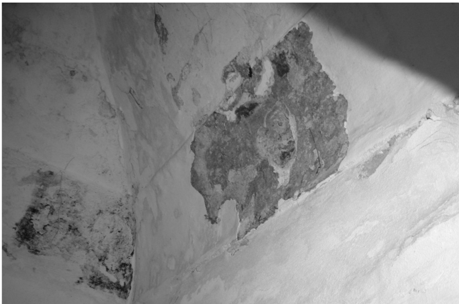
ΕΙΚΟΝΑ 21: Ίχνη χρώματος, τα οποία εντοπίστηκαν κατόπιν δοκιμαστικών τομών στην τοιχοποιία του μνημείου
