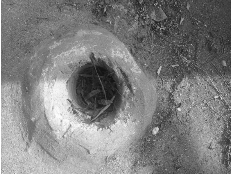
ΕΙΚΟΝΑ 20B: Άποψη αεραγωγού από τη στέγη
