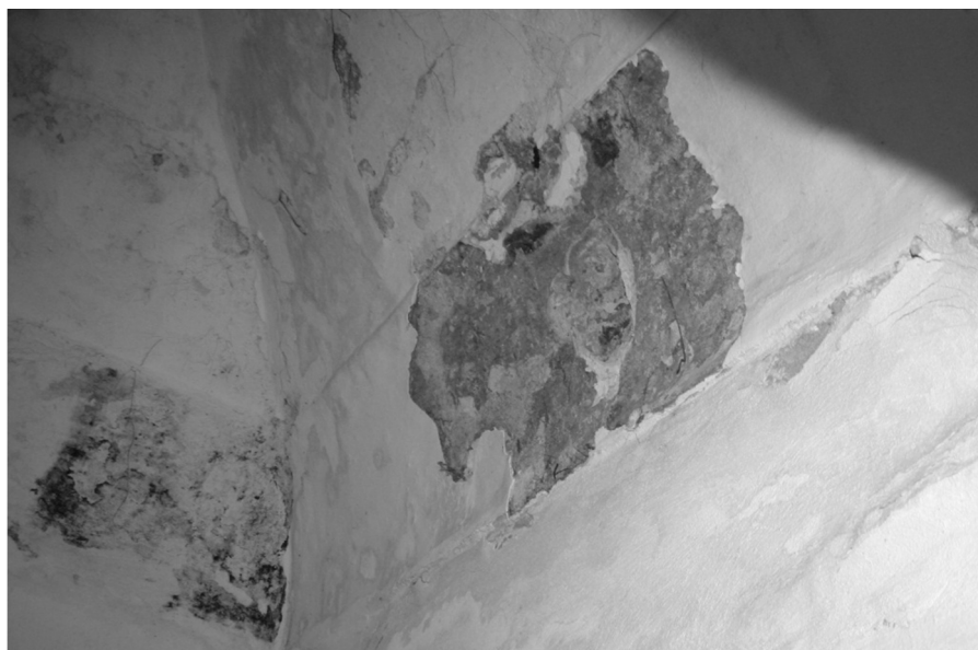
ΕΙΚΟΝΑ 21: Ίχνη χρώματος, τα οποία εντοπίστηκαν κατόπιν δοκιμαστικών τομών στην τοιχοποιία του μνημείου
